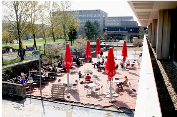
Baustelle rund um die Mensa am Hubland: Durch die Sanierung des roten Platzes ergeben sich Einschränkungen. Foto: Georg Kaiser
