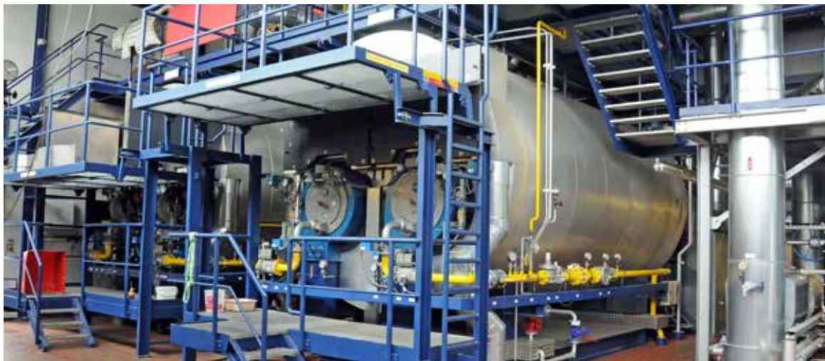
Mit der eigenen Fernwärme versorgt der Technische Betrieb die Universität Würzburg. (Foto: Corinna Russow)
