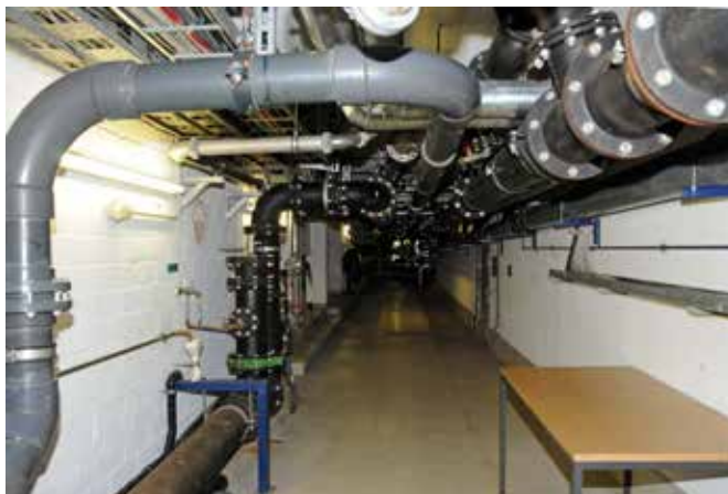
Der Technische Betrieb ist zuständig für das Technische Gebäudemanagement, also für viele Kilometer Wasserrohre und Heizungen. (Foto: Corinna Russow)
