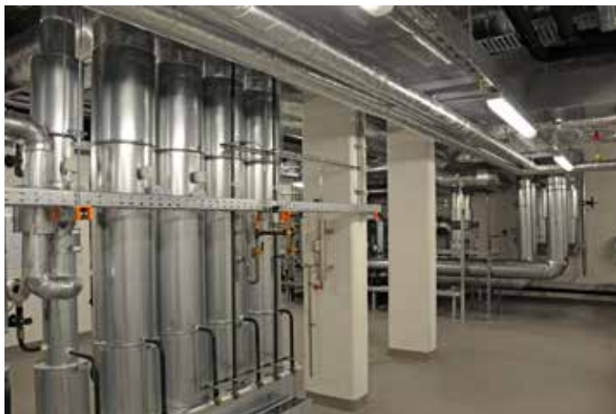
An der Universität gibt es Heizungen aus unterschiedlichen Jahrzehnten. Hier: Heizung aus dem Chemie-Neubau. (Foto: Corinna Russow)
